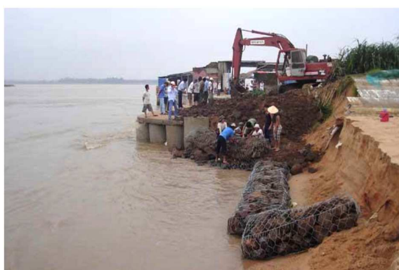
Hình 3.24.a. Xói lở bờ sông Ba (đoạn cầu Đà Ràng đến cửa sông Ba)
