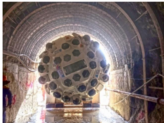
Đào hầm bằng công nghệ TBM 390 E ở thủy điện Đa Nhim mở rộng
