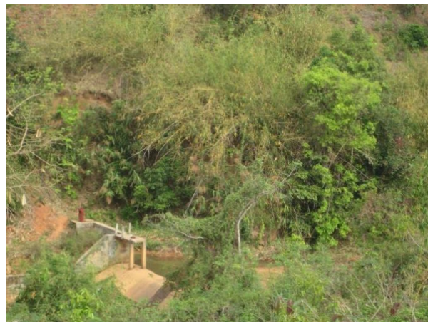
Hình 5.5. Hiện trạng đập Đak Rô Gia xã Đăk Trăm huyện Đăk Tô- Kon Tum
