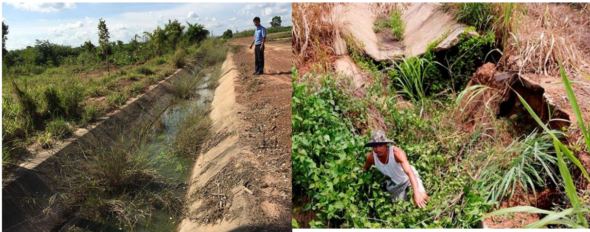
Hình 5.11. Hệ thống kênh chính thuộc Dự án Hồ chứa nước Krông Pách Thượng bị bỏ hoang và hư hỏng nặng (tham khảo ảnh chụp trên internet vào tháng 2/2017)
