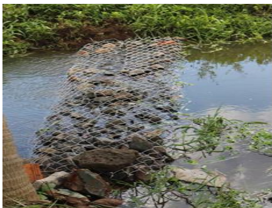
Check dam làm bằng đá bọc lưới thép
