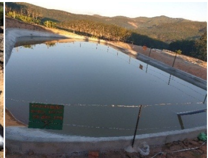
Bể chứa nước
